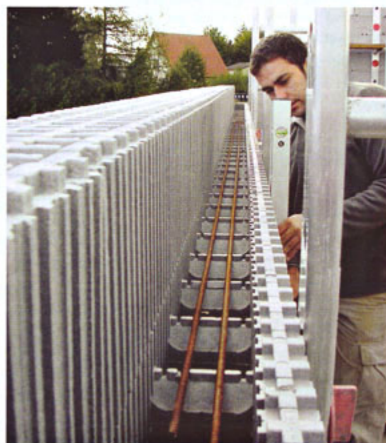
Uložení ztužujících prutů do ztraceného bednění Isorast. V případě tvarovek z nového materiálu Neopor a při tloušťce stěny 35 cm, součinitel prostupu tepla U = 0,14 \text{ W/m}^2 ; čím nižší, tím lepší tepelná izolace.
