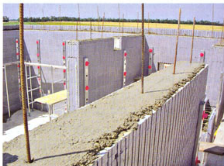
Ztracené bednění zalité betonovou směsí.
